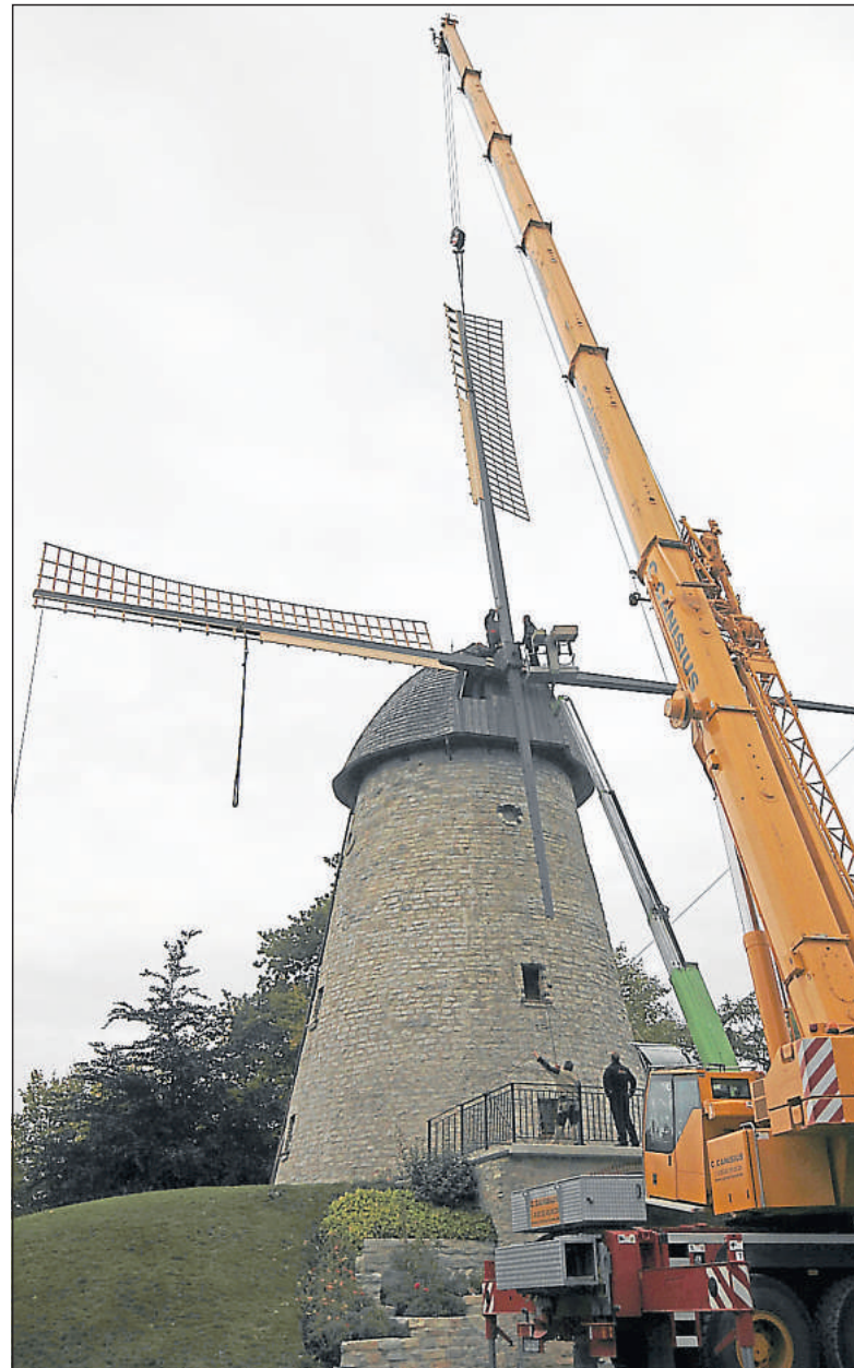
Präzisionsarbeit in 20 Metern Höhe: Mitarbeiter der Firma Möller schoben mit Hilfe eines Krans die 24 Meter langen Flügelruten durch das Mühlenkreuz in Ennigerloh. Bilder: Rautenstrauch
